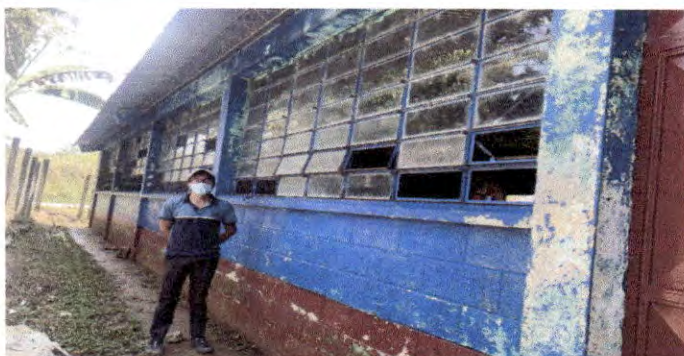
Foto 9: Estructura de metal en ventanas en malas condiciones y con signos de corrosión y sin seguridad.
