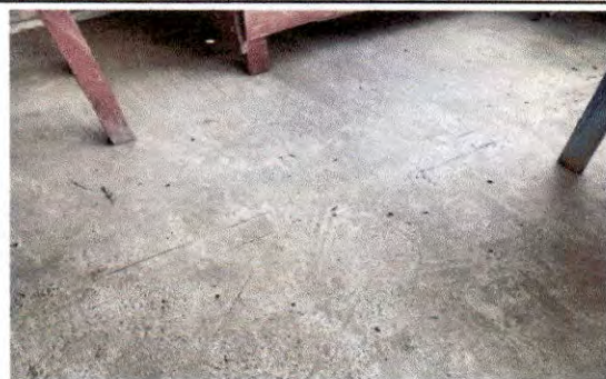
Foto 3: Piso de cocina rajado y manchado.
