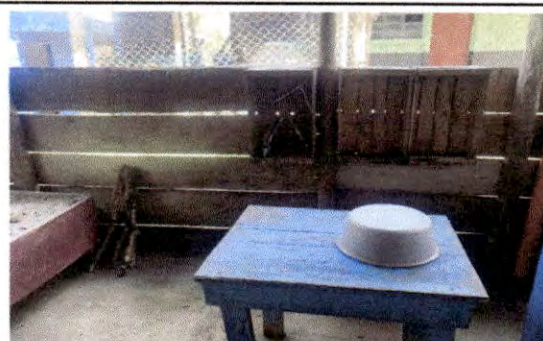
Foto 4: Pared de madera inadecuada y en mal estado
