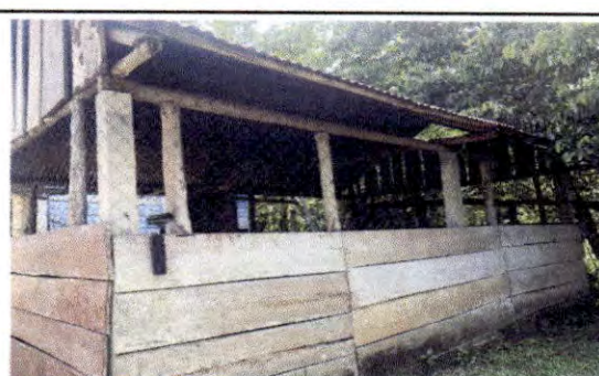
Foto 6: Cocina de madera en malas condiciones.
