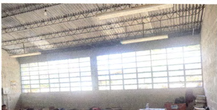
Foto 10: Vista interior de estructura de ventanas en mal estado.
